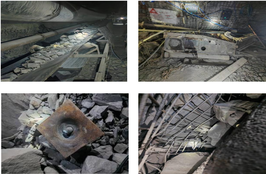
图 4 事故地点现场照片
